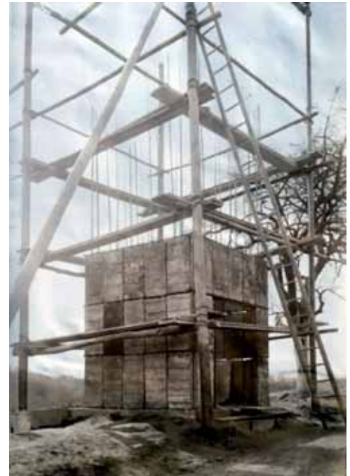
Abb. 18: Dieses Foto zeigt den Aufbau einer aus Fertigbauteilen herzustellenden Transformatorstation „System EW Trier“. Wesentlicher Bestandteil waren ca. 100 x 50 cm große und ursprünglich etwa 7,5 cm starke Betondielen (die Dielenstärke wurde bei späteren Bauausführungen auf ca. 12 cm erhöht), die in eigener Regie aus Kesselschlacke, Sand und Zement in Trier angefertigt wurden. Die Dielen hatten in Längsrichtung zwei Durchbohrungen und zur Erhöhung ihrer Festigkeit eine Drahteinlage. Sie wurden auf der Baustelle auf die Stangen eines aus Rundeisen bestehenden Käfigs gesteckt. In jeder Fuge waren die Rundeisenstangen durch ein gelochtes Flacheisen, dessen Länge gleich der Breite des Hauses war, gegen seitliche Verschiebungen gehalten. An den Ecken befand sich eine Versteifung. Die Rundeisen waren am unteren Ende mit einer Stein-schraube und an ihrem oberen Ende mit Gewinde versehen. Nach Befestigung sämtlicher Dielen wurde das vorbereitete Dach mit seinem Rahmen über die Gewinde-Enden der Rundeisen geschoben und die Muttern des Gewindes lose angezogen. Dann wurden die Stangen unten eingegossen, die Längsdurchbohrungen der Platten vergossen, die Fugen mit Zementmörtel zugeworfen und das Haus außen verputzt. Nach dem Abbinden erfolgte schließlich das Anziehen der Muttern und die Beschieferung des Dachs.
